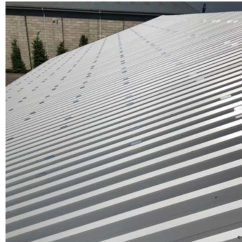
De zonnepanelen op het dak van de bedrijfshal van Brink Recycling glimmen in de zon (foto boven). De foto onder toont de profielen waarop de panelen rusten.
