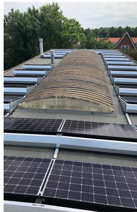
Accessoires als kabelgoten zijn perfect geïntegreerd in het geheel van de zonnepanelen en vallen hierdoor niet op.
