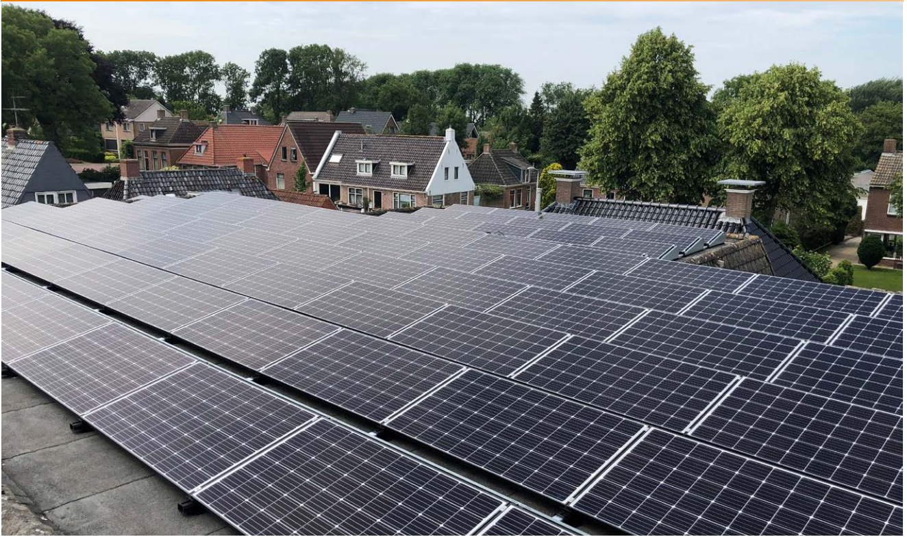
In totaal liggen er 400 zonnepanelen op twee platte daken gemonteerd met het FlatFix-montagesysteem.
