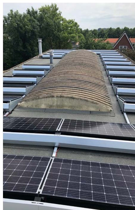
Les accessoires comme les goulottes à câbles s'intègrent parfaitement à l'ensemble des panneaux solaires et par conséquent ne se remarquent pas.
