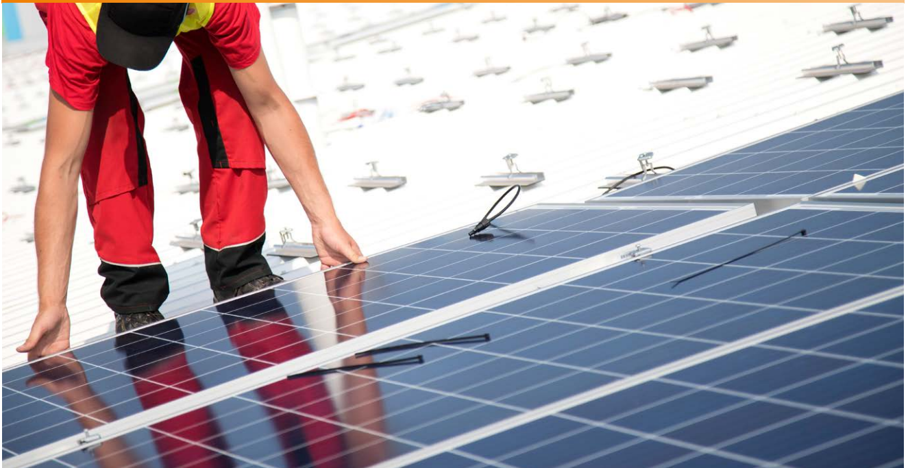
Les installateurs de NOCO2 encliquettent facilement les panneaux solaires dans les profilés du système ClickFit EVO.
