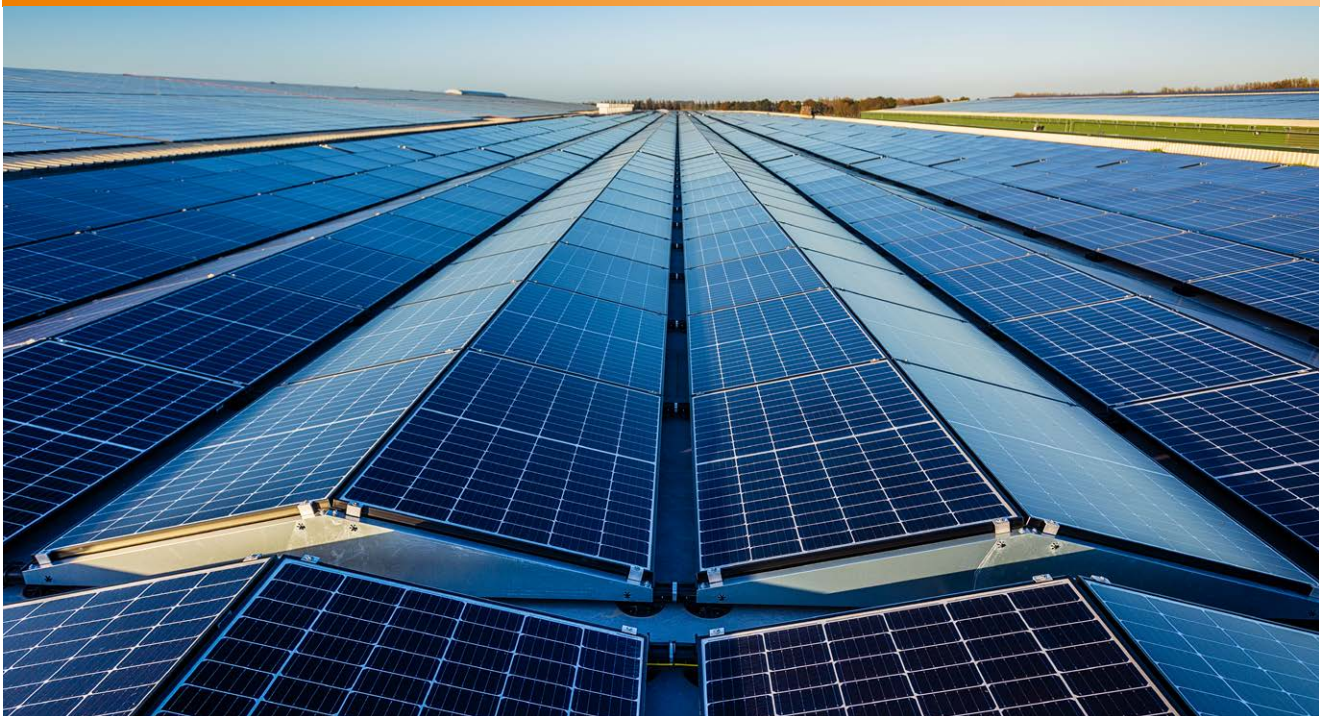
Sous le soleil du Noordoostpolder : 50.000 m 2 de panneaux solaires, pour une production de 6 GigaWh/an.
